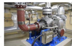
原子炉圧力容器から発生する蒸気を駆動してポンプを回し、原子炉へ注水する設備で、全ての電源を失った場合(全交流電源喪失時)でも注水できます。
