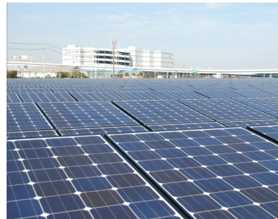
太陽光発電所
